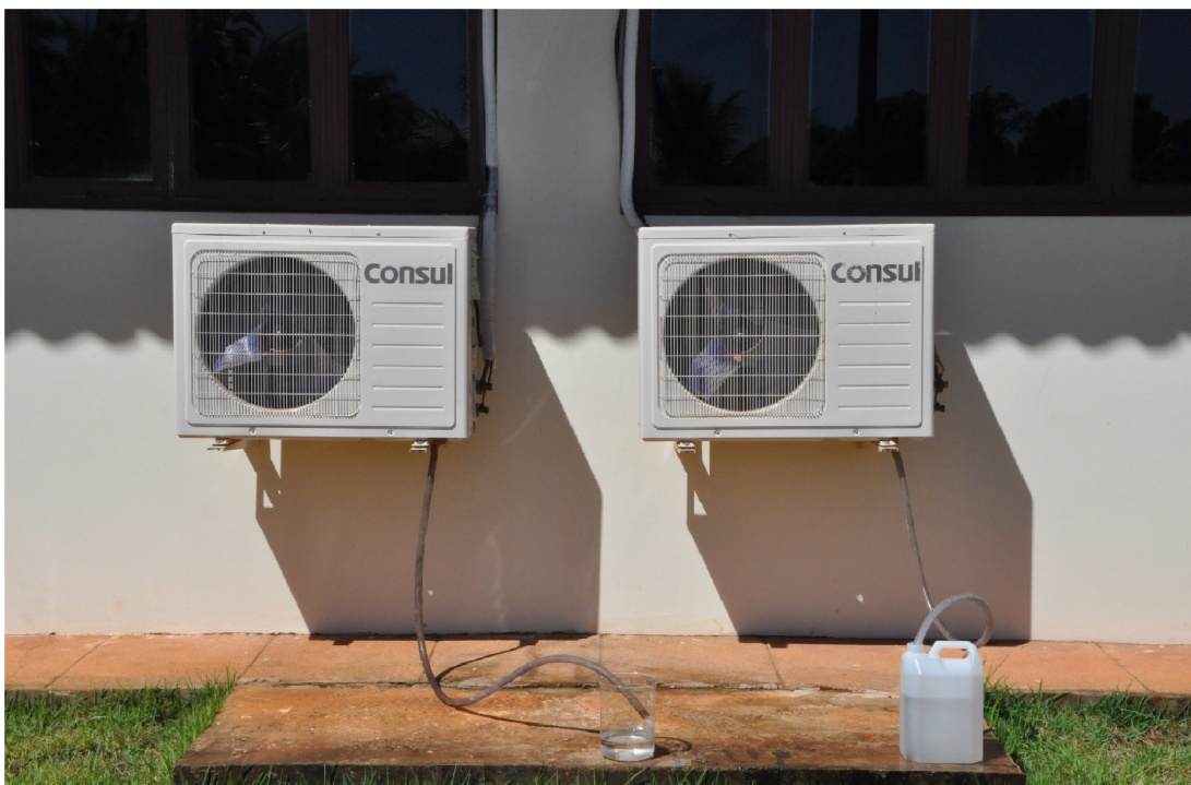
Figura 01. Aparelho de ar condicionado
