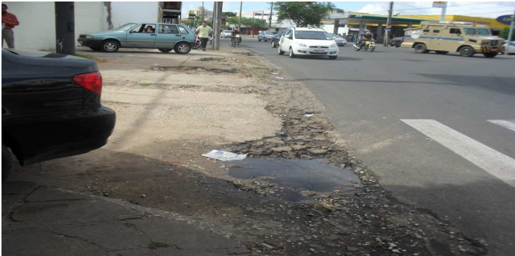
Figura 03 – Calçada sem sarjeta e com acúmulo de esgoto, Av. Miguel Rosa. (fonte autor)
