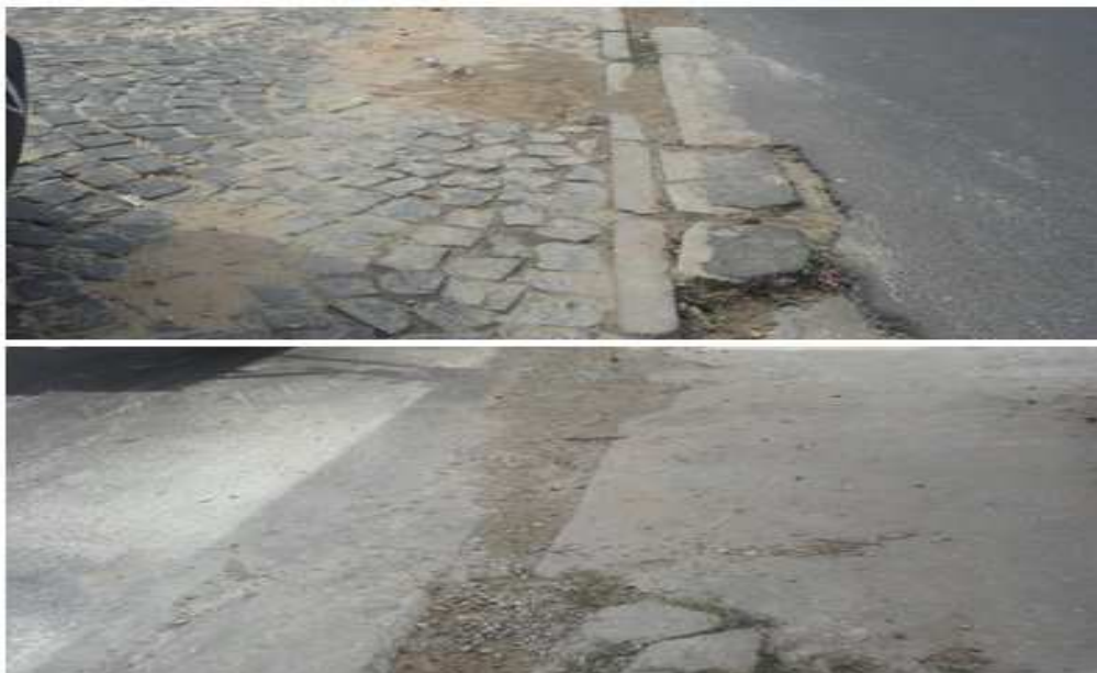
Figura 08 – Sarjetas bloqueadas Av. Miguel Rosa. (fonte autor)
