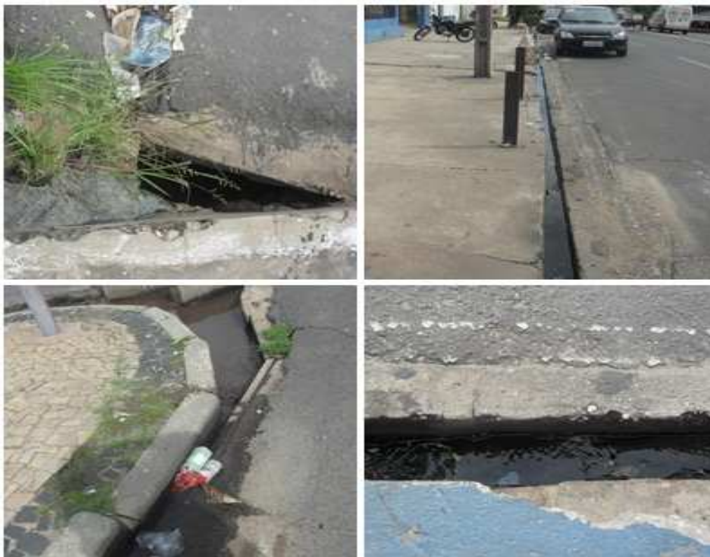
Figura 02 – Diferentes tipos de Sarjetas no decorrer da Av. Miguel Rosa (fonte: autor)
