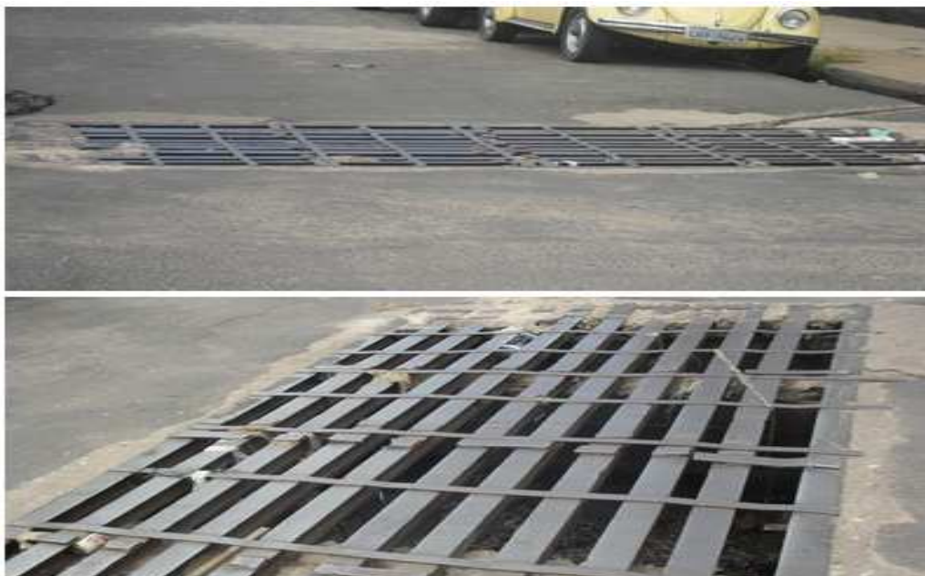
Figura 07 – Boca de Leão com caixas na Rua Mte. Estevão com Av. Miguel Rosa. (fonte autor)
