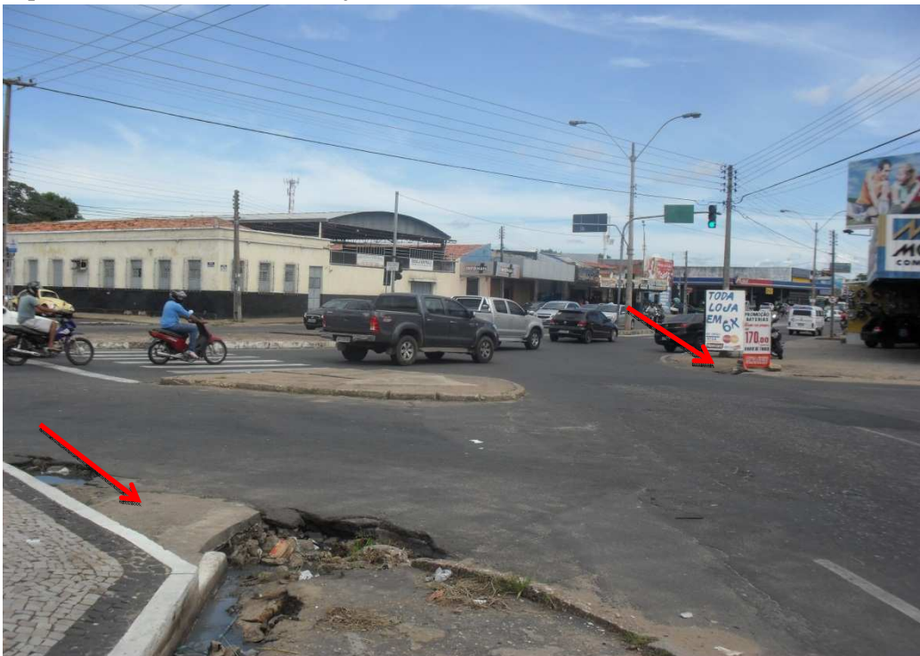
Figura 04 – Localização de Bocas Coletoras, Cruzamento da Av. Miguel Rosa com Rua Des. Pires de Castro. (Fonte autor)
