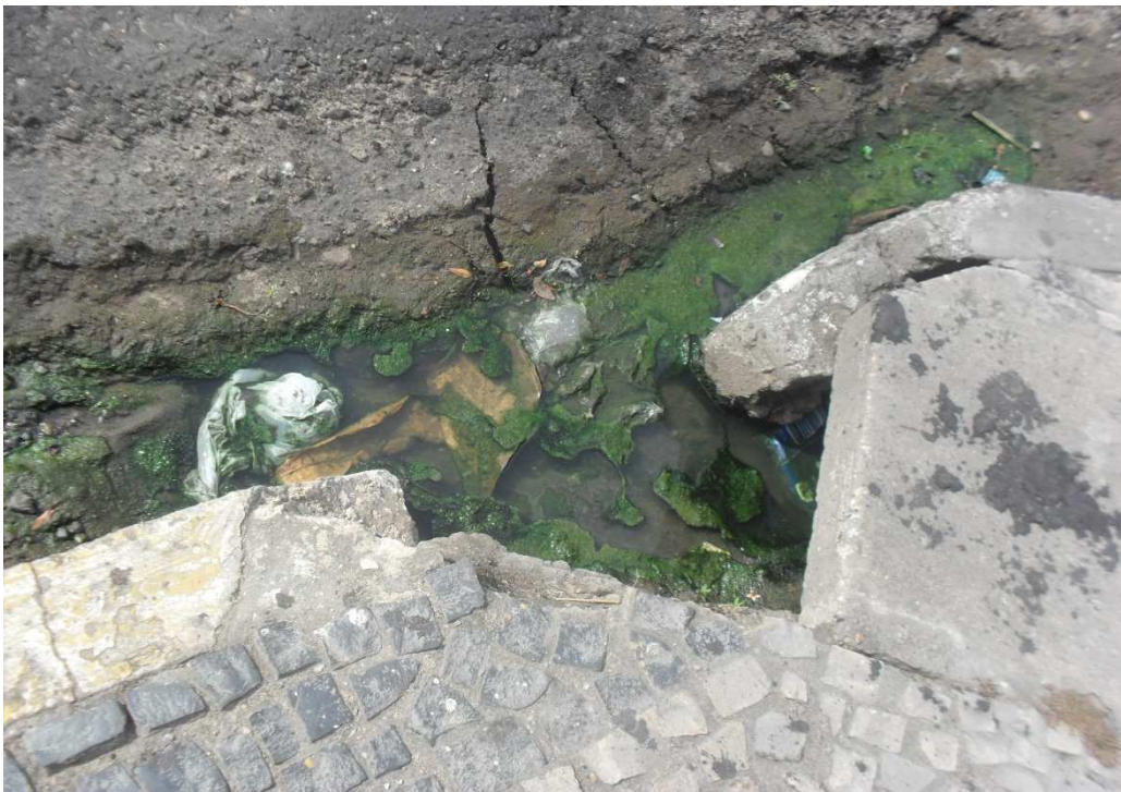
Figura 05 - Boca coletora localizado no cruzamento da Av. Frei Serafim com Av. Miguel Rosa (fonte autor)
