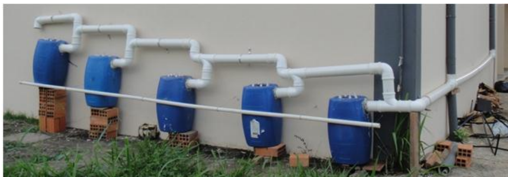
Figura 6 - Vista frontal do sistema de coletores de água de chuva.
