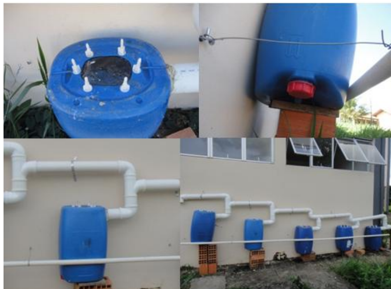
Figura 5 - Coletores reaproveitados de PEAD e canalização de PVC.
