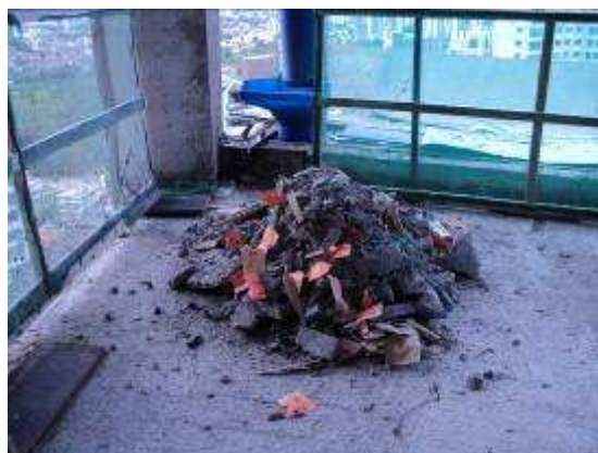
Figura 2 – Resíduos de blocos de concreto misturados a outros resíduos
