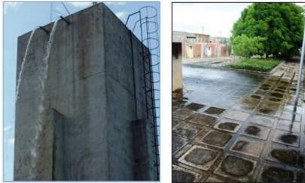
Figura 4: Reservatório extravasando e alagamento na região dos reservatórios
