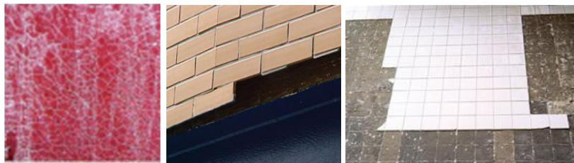
Figura 6: Algumas patologias - gretamento, empenamento e descolamento.
