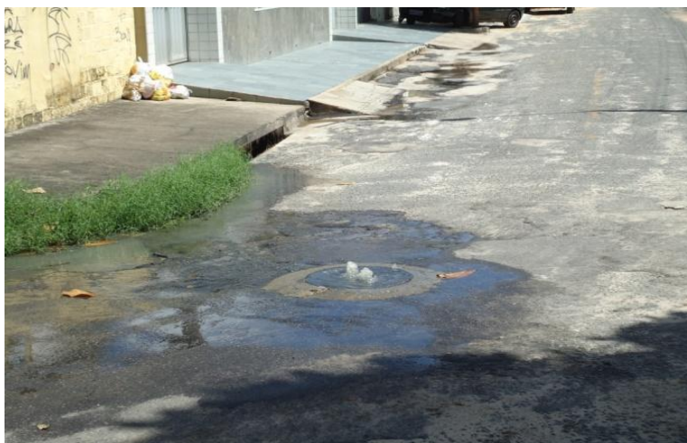
Figura 2: Transbordamento de esgoto no Ponto 3.
